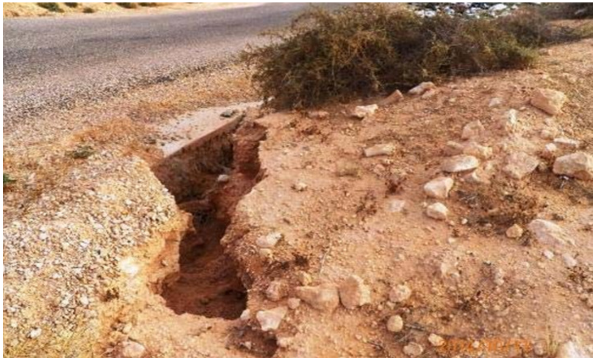
Photo 6. Erosion en point de concentration d'écoulement
